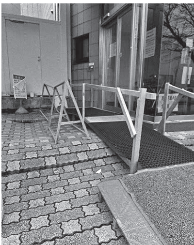
地盤隆起により傾いた医院玄関。スタッフがスロープを作成(七尾市)
