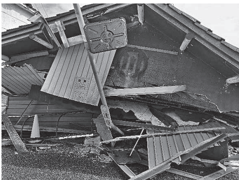
倒壊した家屋(穴水町)
